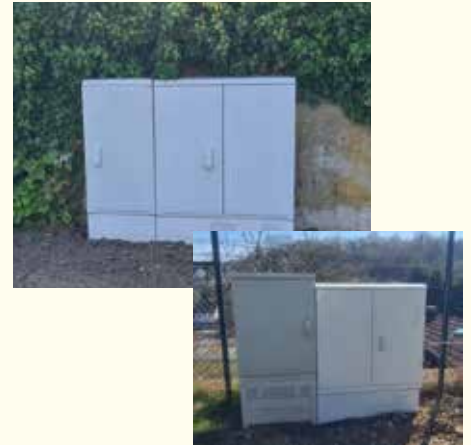
Das neue „Herz“ des Schützenplatzes (Strom- und Wasserversorgung)
