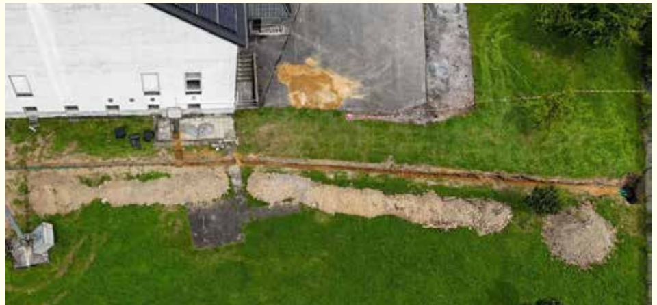
An verschiedenen Stellen wird künftig die Strom- und (neu) auch Wasserversorgung des Schützenplatzes gewährleistet
