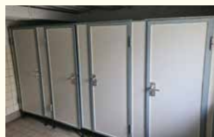
Teilweise (2 von 4) nicht mehr nutzbar.
